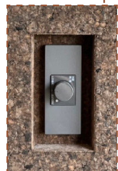
主空間開關(右): 可調光間接照明；按壓下方打開燈光，旋轉圓鈕調整亮度。 玄關架高區開關(左): 崁燈；按壓開關
