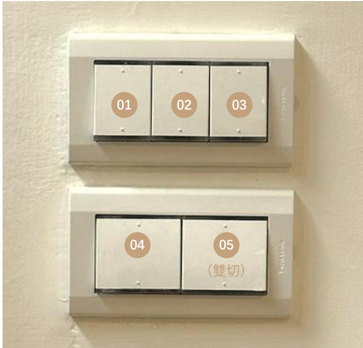
主入口左側牆面燈具開關面板
